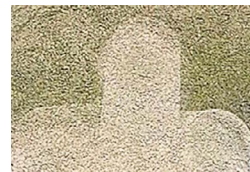
Fasáda napadená zelenou řasou po čištění
