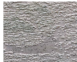
Degradace fasádní stěrky po 12 letech
